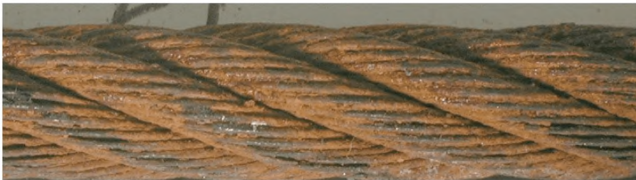
Рисунок Ж.4 — Поверхность проволочек сильно поражена точечной коррозией, язвочки на проволочках, ослабленные проволочки, просветы между проволочками. Степень повреждения — 100 % — выбраковка каната
